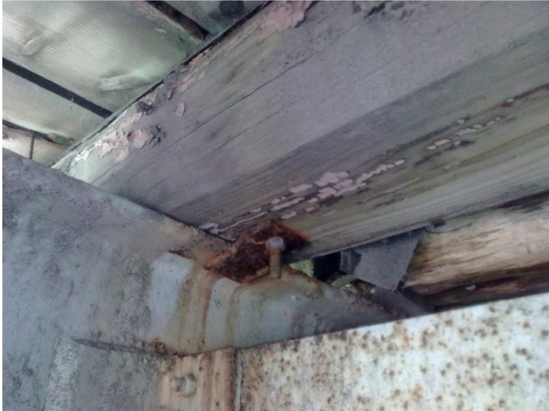
Korozja łączników pomiędzy dźwigarami, a poprzecznicami drewnianymi
