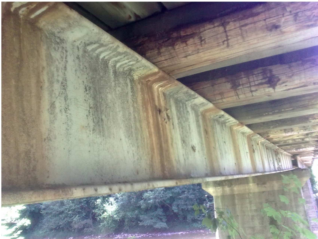
dźwigarów głównych oraz korozja powierzchniowa
